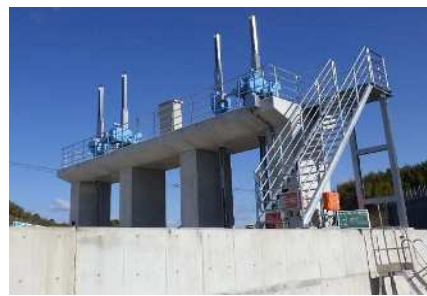
那賀川呑口調整ゲート（中国四国農政局）
